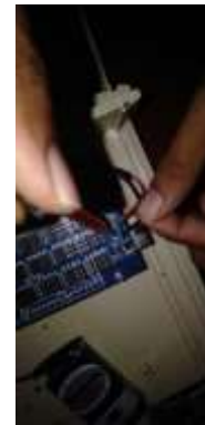
Gambar 16. Instalasi catu daya
